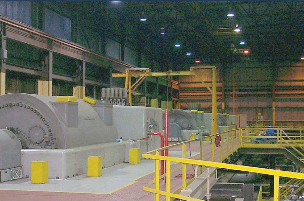
Generadores de nivel 2 con tuberías de muestreo VESDA en un área protegida, y unidad de detección montada en una sala de control para facilitar el acceso y el mantenimiento.
